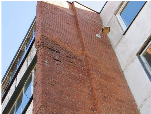
7 Pav. Fasado fragmentas. Ištrupėjęs plytų mūras.
