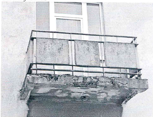
Balkonas, betoninės konstrukcijos apirė
