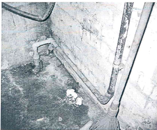
Vandentiekio įvadas, skaitiklio nėra, vamzdynai pakeisti
