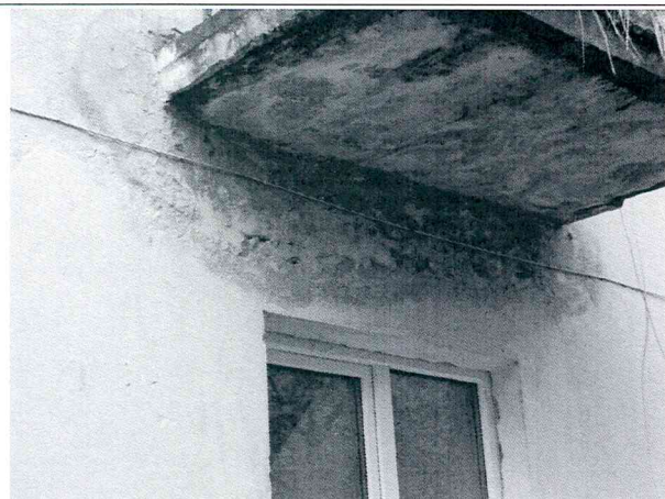
Fasadas pažeistas drėgmės
