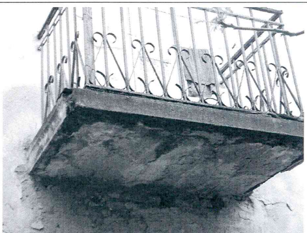
Balkono konstrukcija stipriai suirusi
