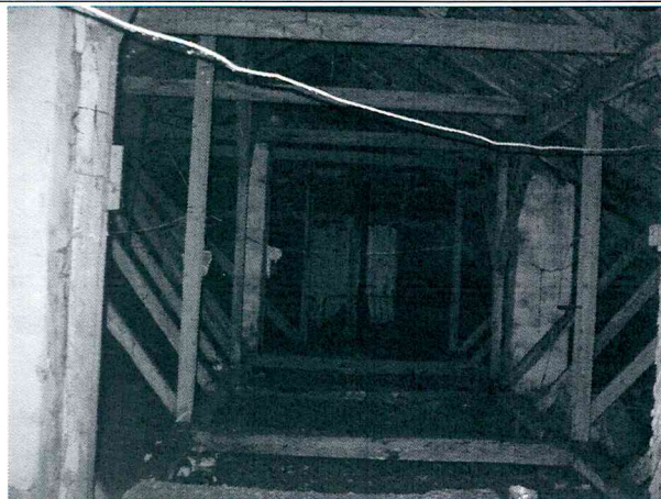
Medinė stogo konstrukcija vietomis pažeista puvinio
