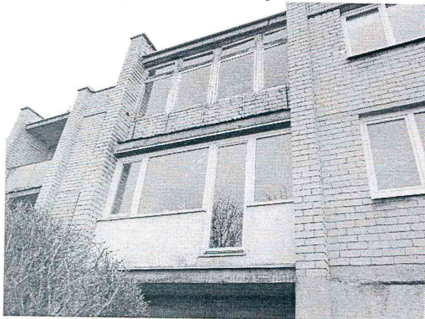
5 pav. Galinis fasadas, rekonstruota balkono atitvara
