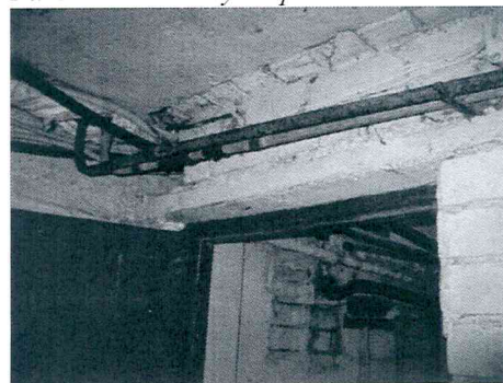
Pav. 14 Šalto vandentiekio vamzdynai rūsyje
