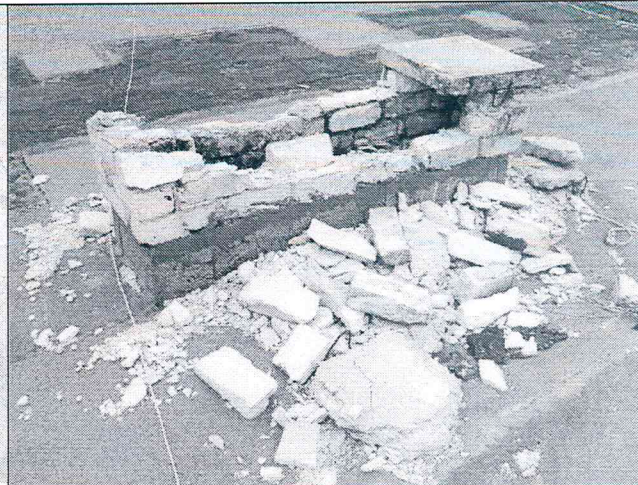
16 pav. Apgriuvę vėdinimo kanalai ant stogo
