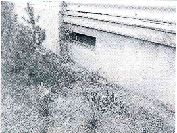
Betoninė atgrinda apnešta gruntui, įdubusi
