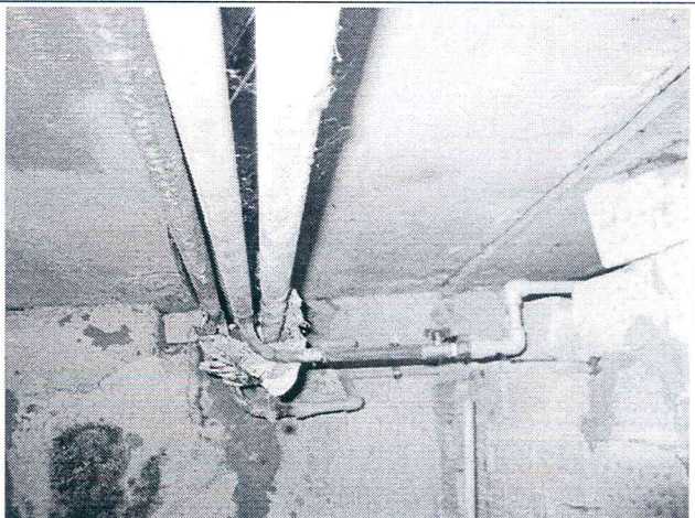
Seni, neizoliuoti vandentiekio magistraliniai vamzdžiai
