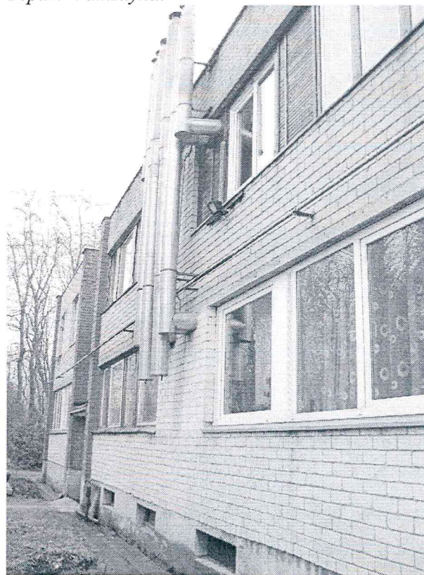
16pav. Dujinių katilų dūmtraukiai ir ventiliacijos kanalai
