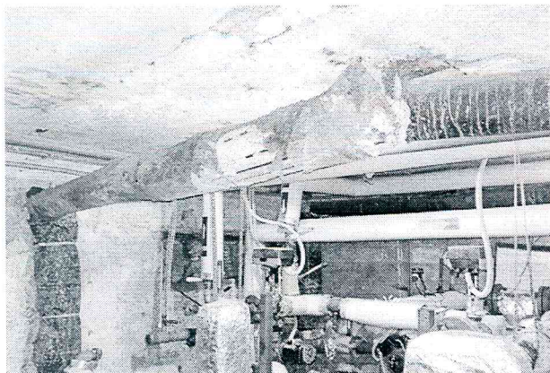
Šildymo sistemos magistraliniai vamzdynai, asbestinė izoliacija
